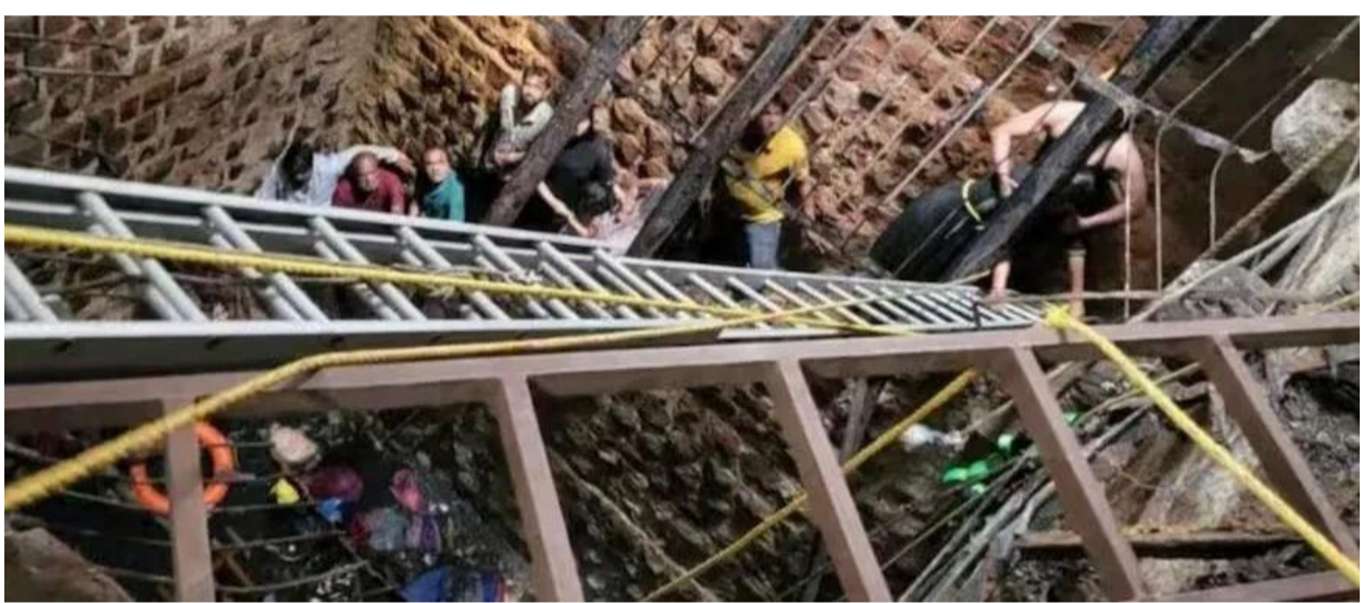
ഇൻഡോറിലെ ബലേശർ മഹാദേവ് ജ്യലേശ്വർ ക്ഷേത്രത്തിലെ കിണർ ഇടിഞ്ഞതിനെ തുടർന്ന് കിണറിനടിയിൽ കുടുങ്ങി കിടക്കുന്നവർ
